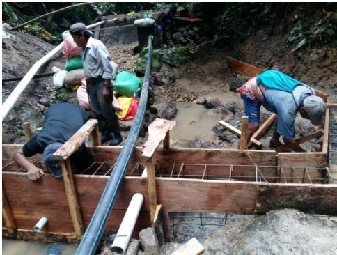
Wasserfassung in „San Jose“.
